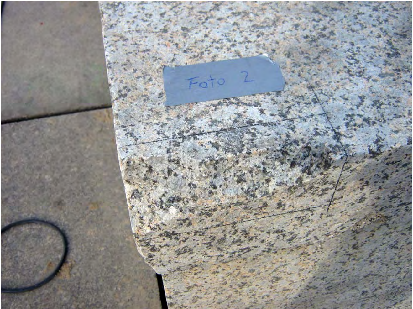
Abbildung 37 Ausbruch an Ecke
