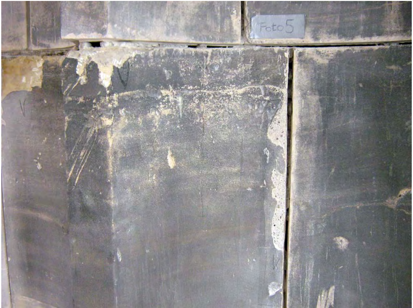
Abbildung 16 Schadstellen an den Steinkanten
