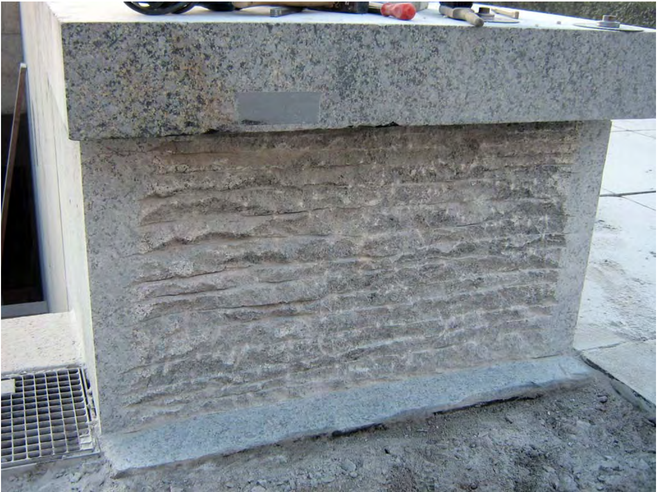
Abbildung 41 Ausarbeitung an Oberflächenschäden
