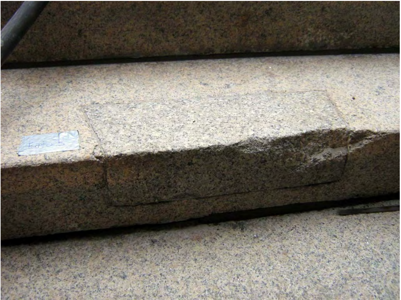
Abbildung 43 Ausbruch an Altvierung
