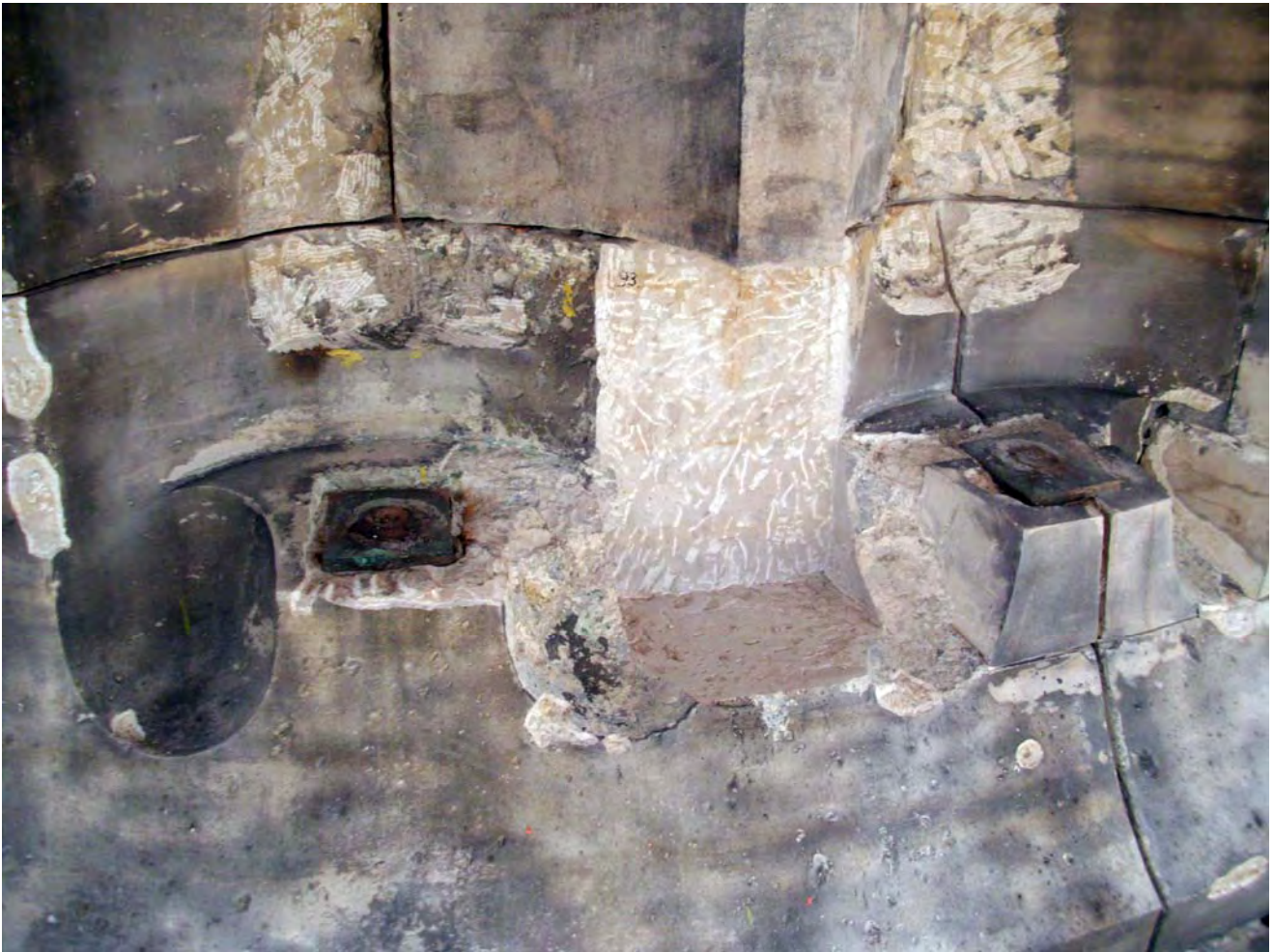
Abbildung 19 Schäden an Kanonenauflage
