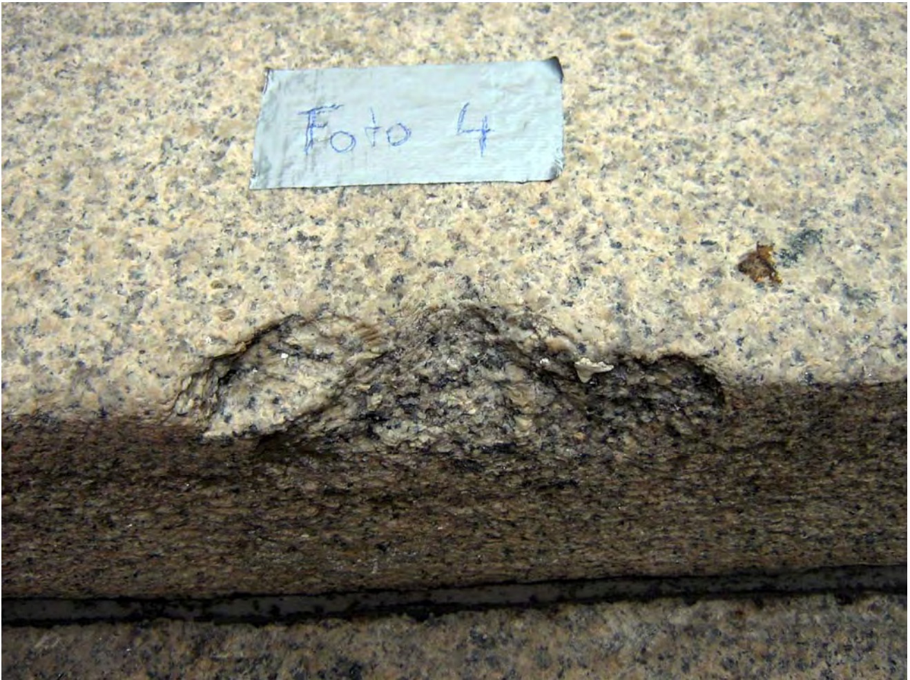
Abbildung 46 Ausbruch an Kante
