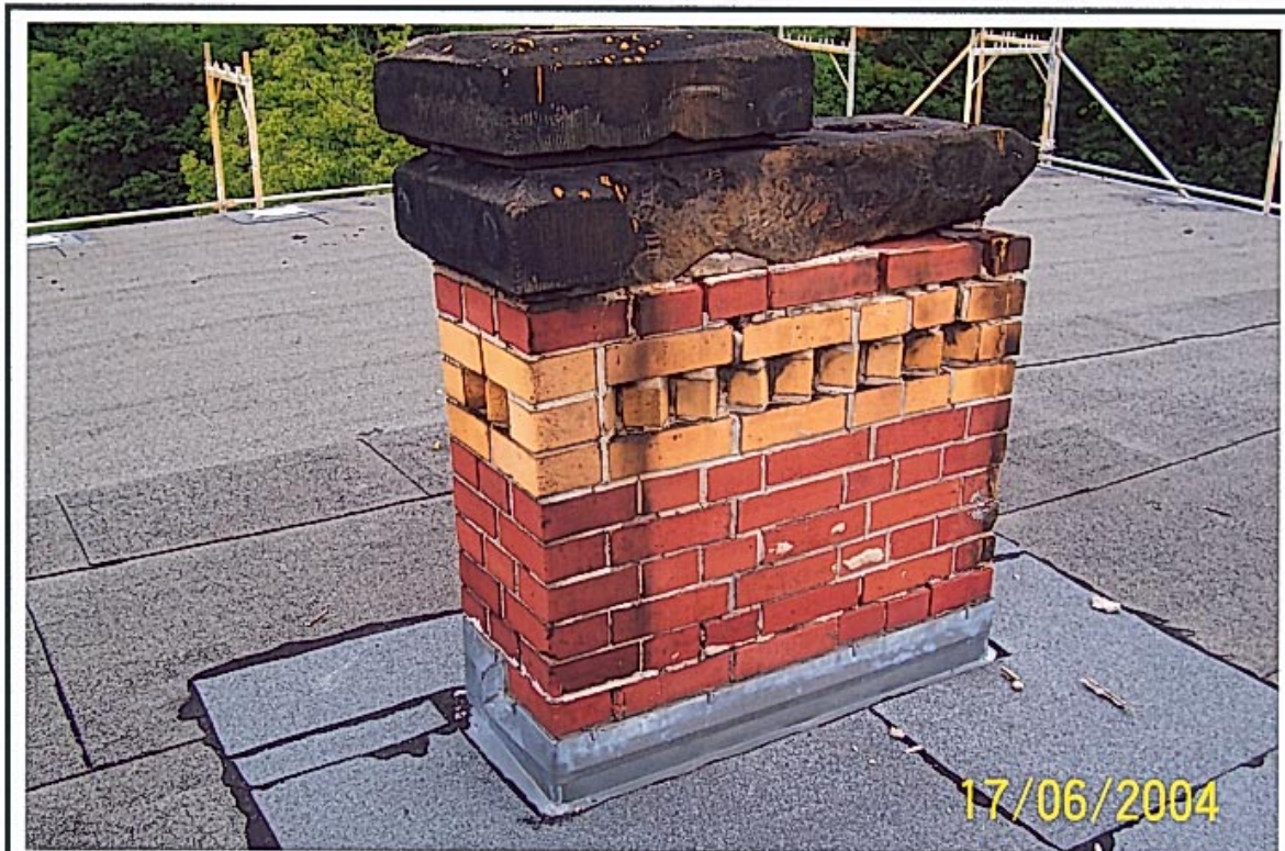
Ansicht Dach Westseite Bauteil Essenköpfe Nr. 05 Kategorie Vorzustand Kommentar defekter Essenkopf 3-zügig
