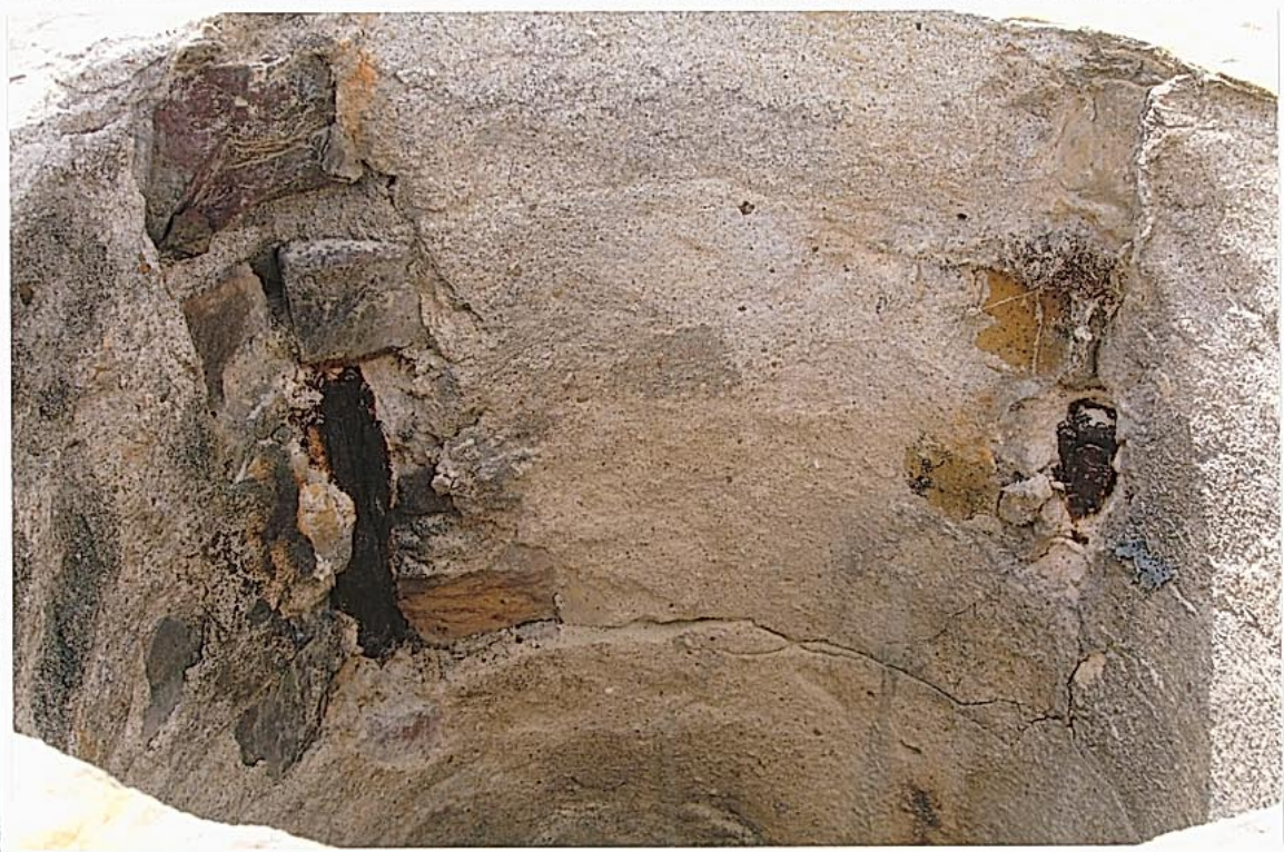
Ansicht Dach Nordseite Bauteil Essenkopf Nr. 27 Kategorie Vorzustand Kommentar Innenaufnahme Essenschacht
