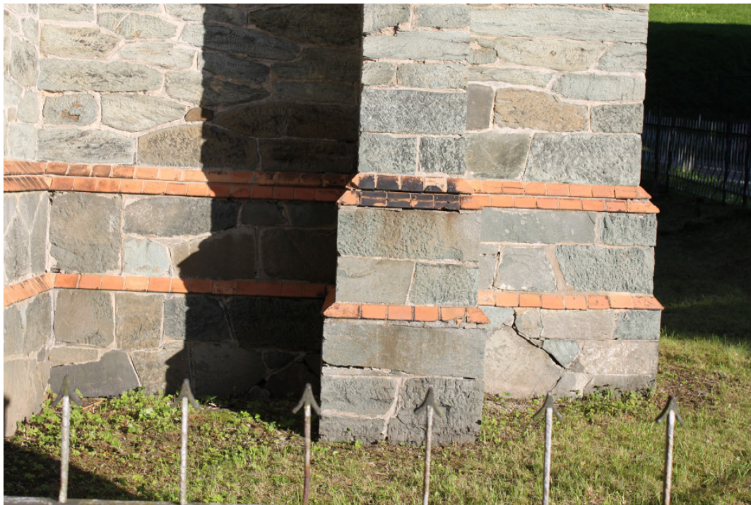
Bild 3: Sockelabdeckungen aus Klinkern, Fehlstellen Naturstein
